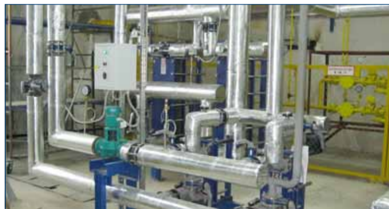
Обновленная котельная Мышкинской ЦРБ работает надежно.
