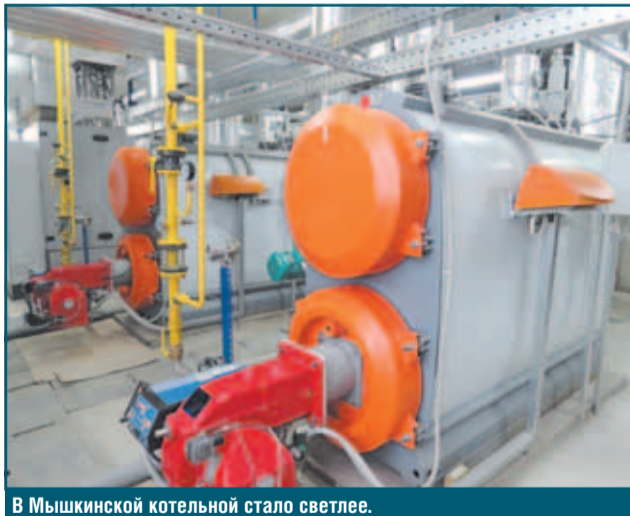
В Мышкинской котельной стало светлее.
